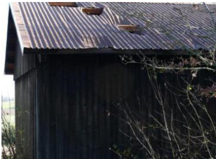
Eisgeschosse von einem 130 Meter entfernten Windrad haben drei Löcher in das Blechdach geschlagen. Ein Schädeldach wurde zum Glück nicht getroffen
